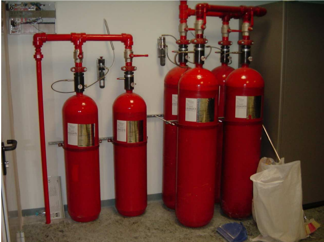
Εικόνα 1. Φιάλες του αυτόματου συστήματος κατάσβεσης τοποθετημένες σε εσωτερικό χώρο του υπόγειου προστατευμένου οχυρού «ΔΙΑΣ».
