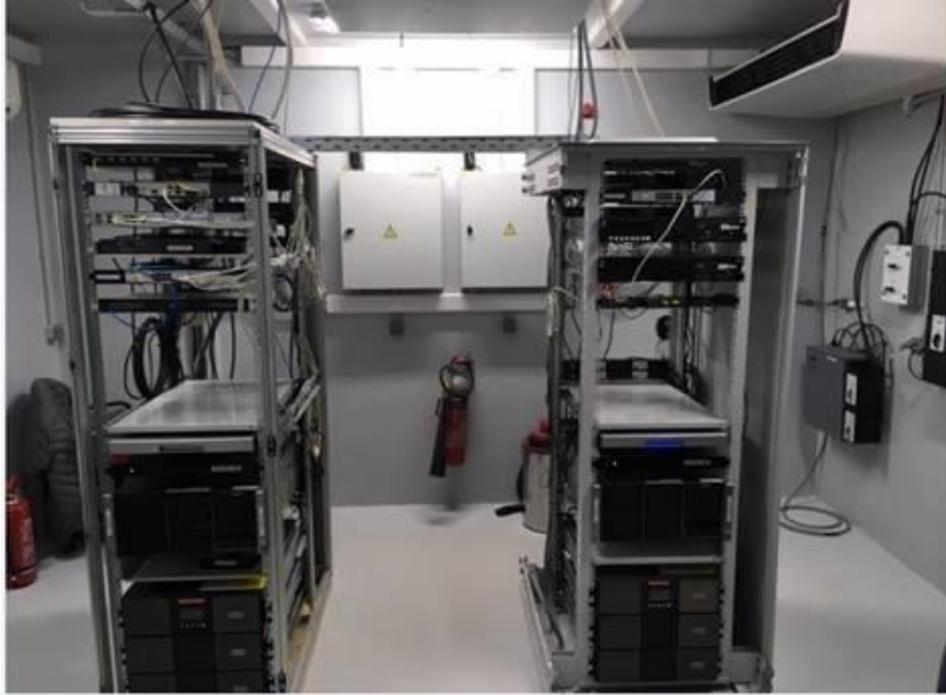
Εικόνα 7. Εσωτερικό Κτηρίου Ελέγχου/Λήψης/Επεξεργασίας/Διανομής.
